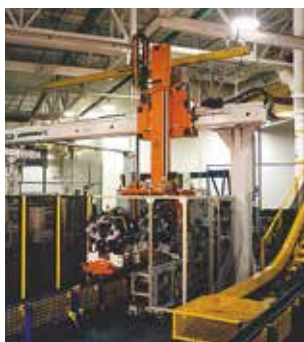
Catene MC su impianto di manipolazione
