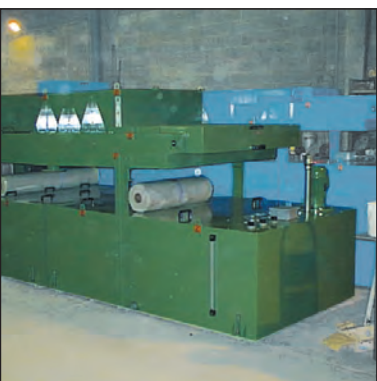
Impianto con filtro a tessuto, portata 700 litri
