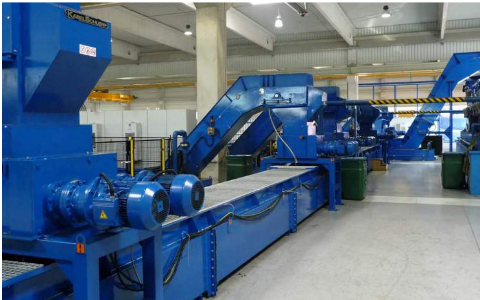
Centrálna likvidácia triesok a úprava. Central chip disposal and processing.
